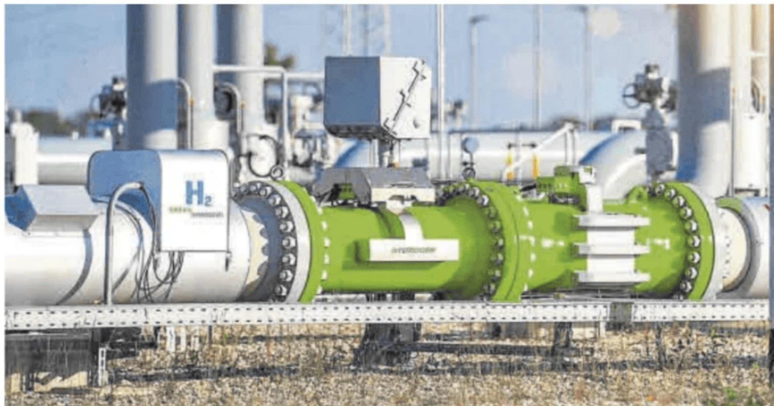
Conductos de hidrógeno verde.
